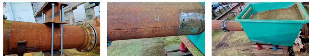
a) Toegepaste vervorming (ovalisatie) b) Oppervlakkig wanddikteverlies c) Bak met grond
