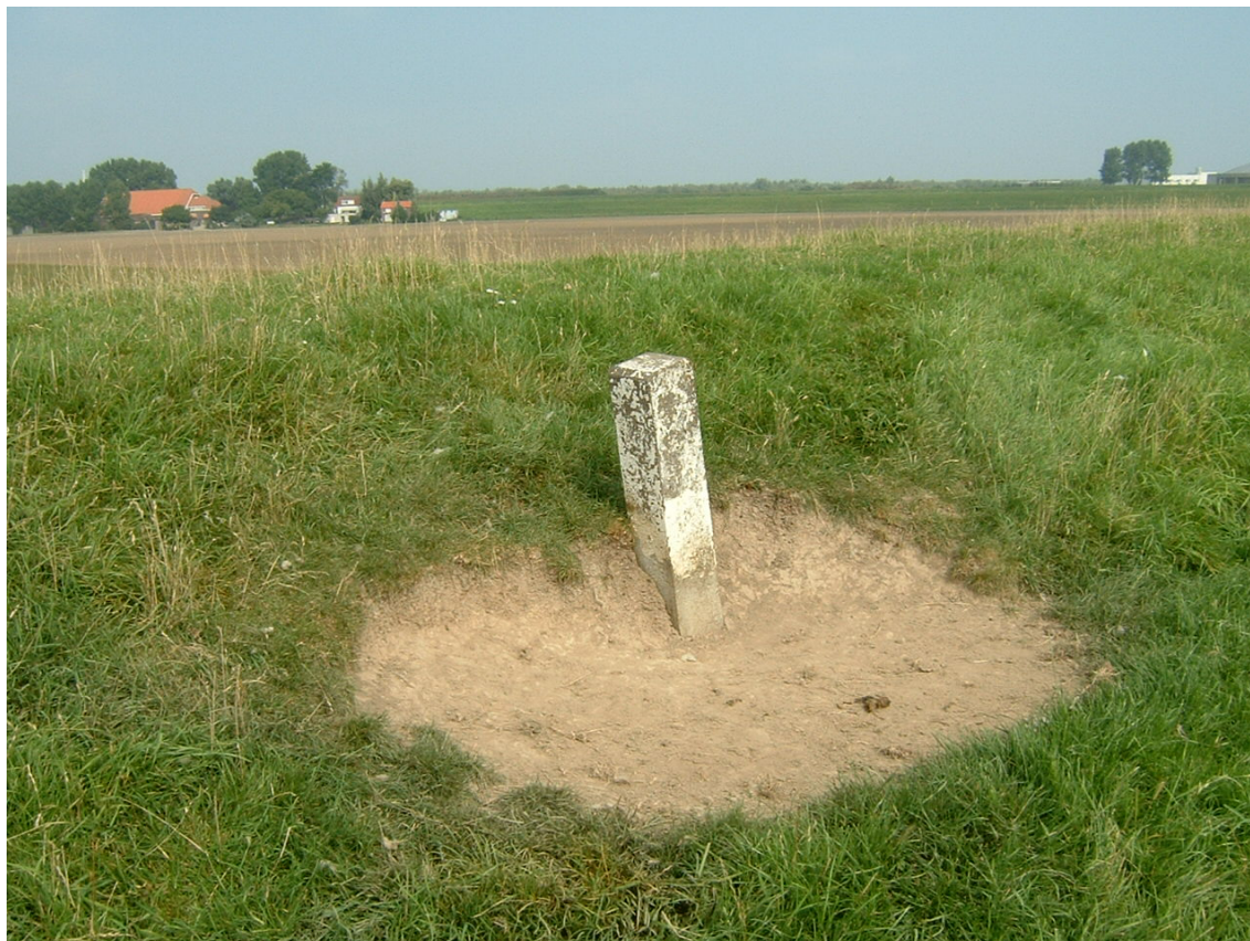
FIGUUR 8 GEBREK KALE PLEK IN BOUWDEEL BEKLEDING MET MATERIAAL GRAS, VEROORZAAKT DOOR VEE BIJ EEN DIJKPAAL [FOTO: WS HOLLANDSE DELTA]
