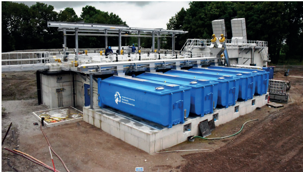
FIJNZEEFINSTALLATIE RWZI BEEMSTER
