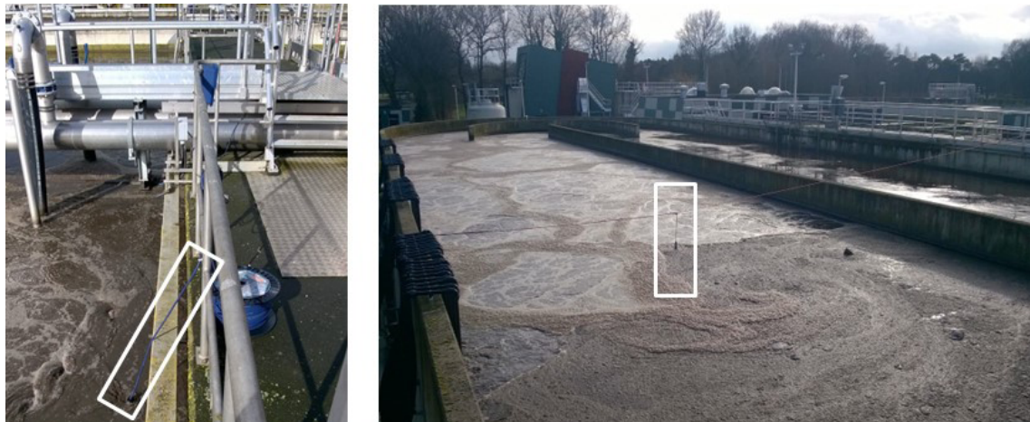
FIGUUR 3.1 INSTALLATIE LACHGASSENSOR IN LINKS NIEUWEGEIN IN STALEN PIJP EN RECHTS AAN EEN TOUW IN HET MIDDEN VAN HET BELUCHTINGSVELD IN SOERENDONK
